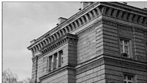
Fasada budynku wymaga gruntownej odnowy
